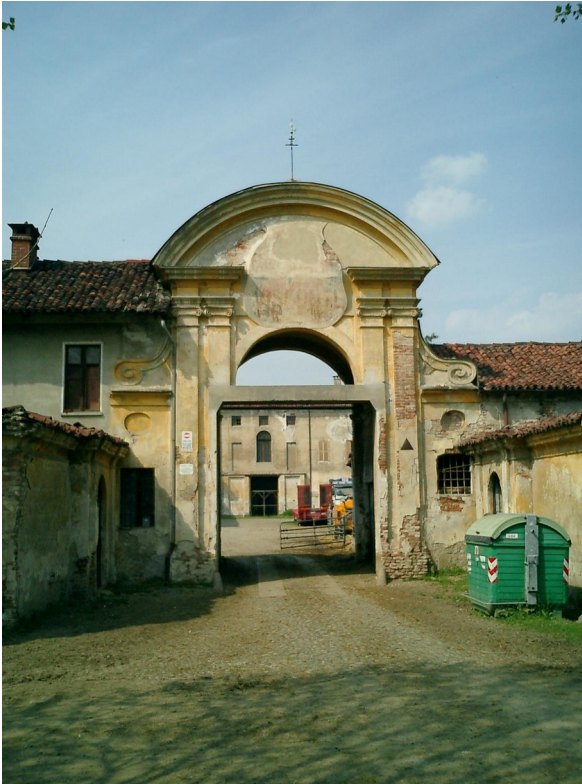
Figura 5. Il portale d'ingresso del Castello di Santa Cristina in Comune di Borgaro: interessante complesso in stato di elevato degrado.
